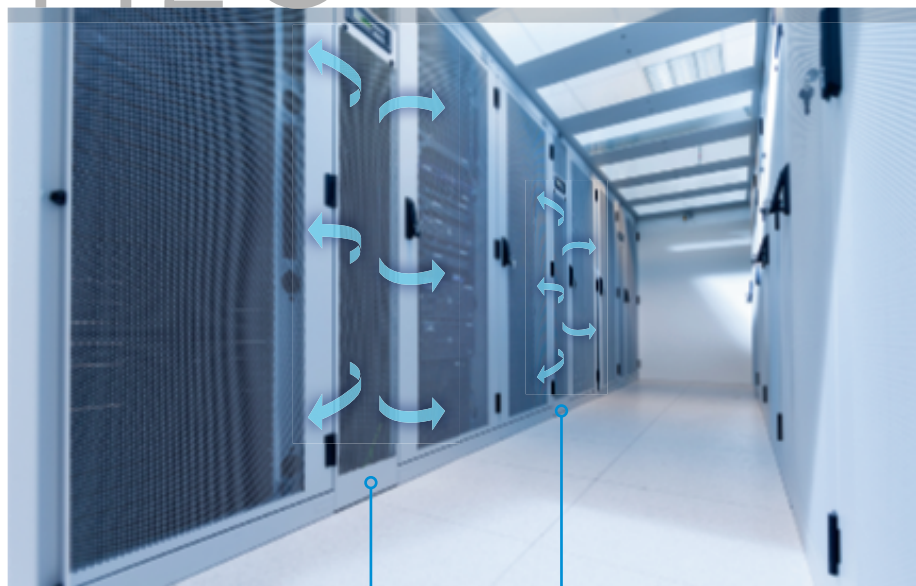
Exemple de système de refroidissement H 2 O dans une allée froide confinée
