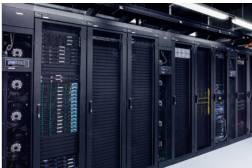
Intégration du refroidissement H 2 O pour optimiser l'efficacité énergétique
