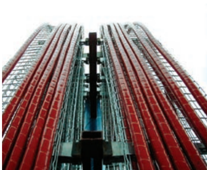
Exemple d'espace supplémentaire utilisé par une distribution de chemin de câbles
